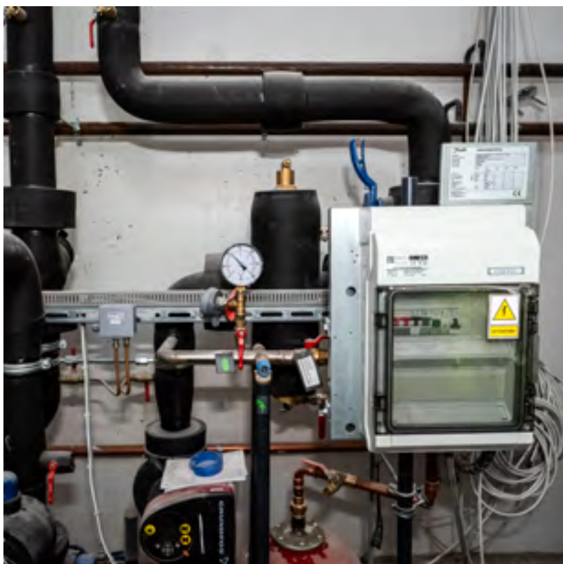
Viileä vesi lähtee putkistoihin talon jakokeskuksesta. Rakenteilla oleviin kauko- lämpökohteisiin jäähdytys voidaan usein toteuttaa asentamalla lämmön- vaihdin järjestelmään.
